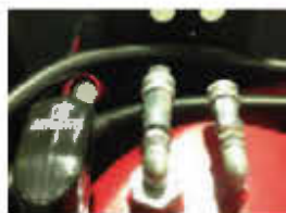
Piquage "Entrée-Sortie" Push-Pull pour groupe électrogène
