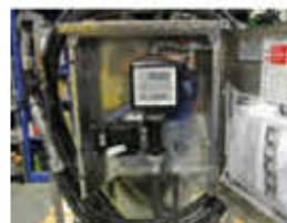
Armoire de distribution aviation
